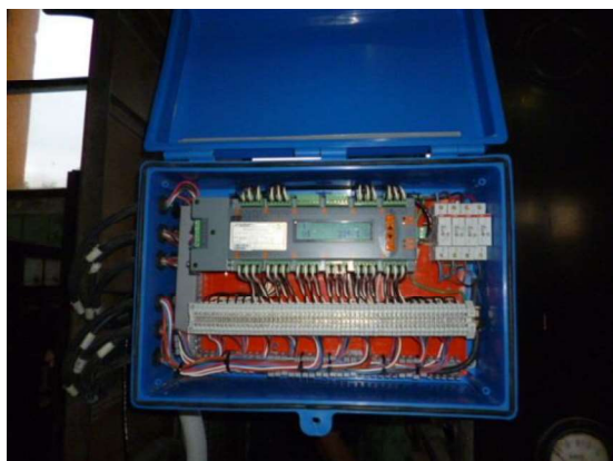
Imagen Nº 3 – Multimetro instalado en su gabinete.
