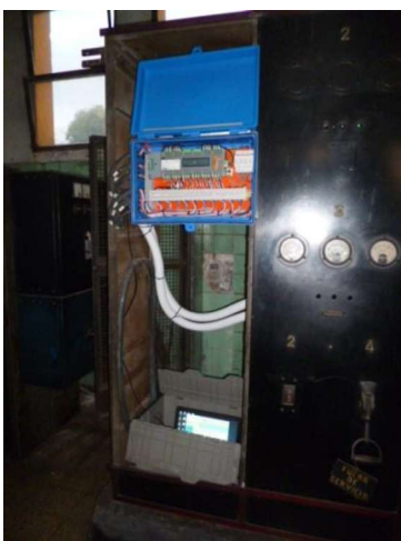
Imagen Nº 5 – Equipo de medición completo instalado en la usina.
